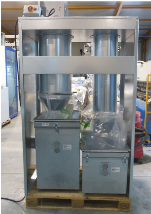
Filteranlage der Firma Schuko.
